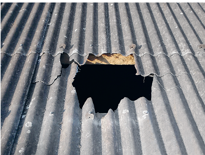
Abb. 8: Durchbruch bei Faserzementwellplatten
